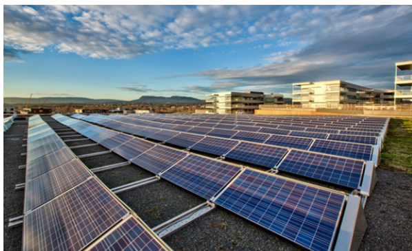
Figur 4: Solcelleanlegg på tak av Fornebu S. Panelene er montert med 20° helning mot sør.
