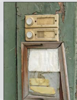
DØRSKILT: Dårlig skilting gjør det vanskelig å finne fram.
