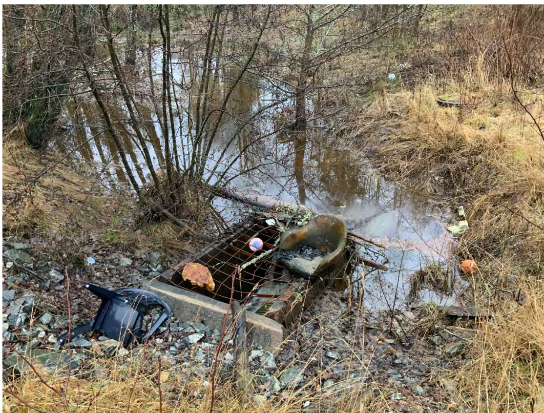
Figur B16 Blokkert innløp ved kryssing av Rokkeveien, Lerdalveien, Lerdalsbekken. Ansvar og tilsyn er et gjennomgående tema for slike kryssinger.
