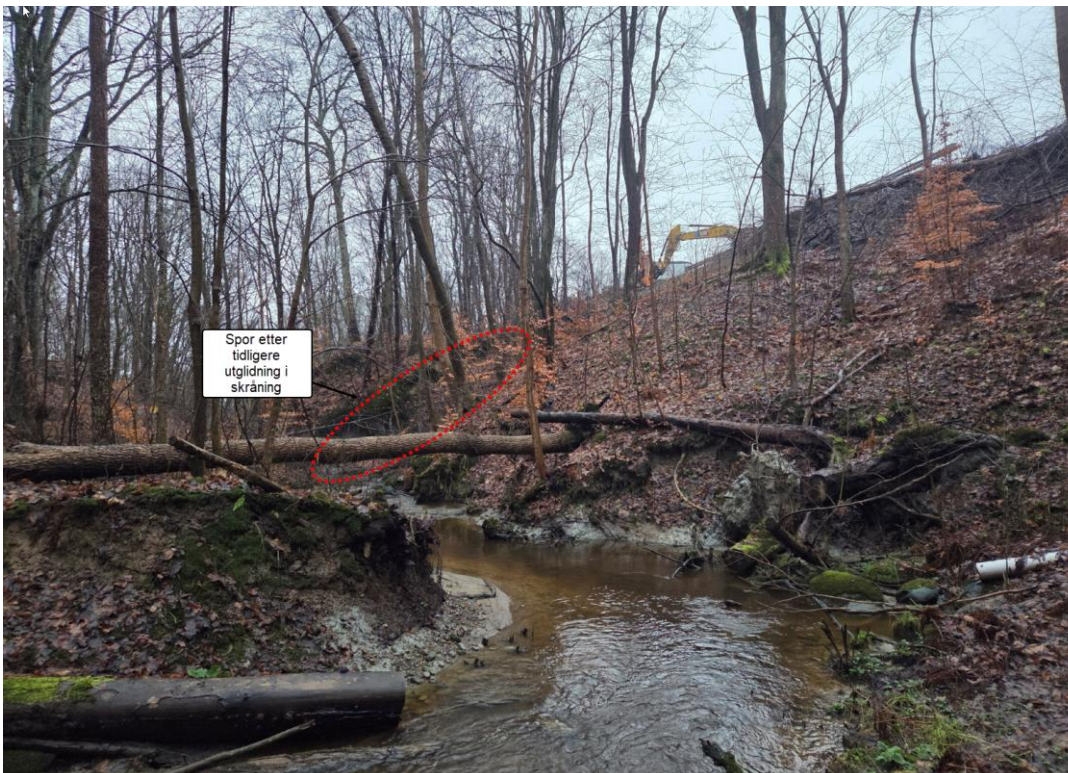
Figur 6-9: Bilde tatt mot sør. Spor etter tidligere utglidning i skråningen i terrenget.
