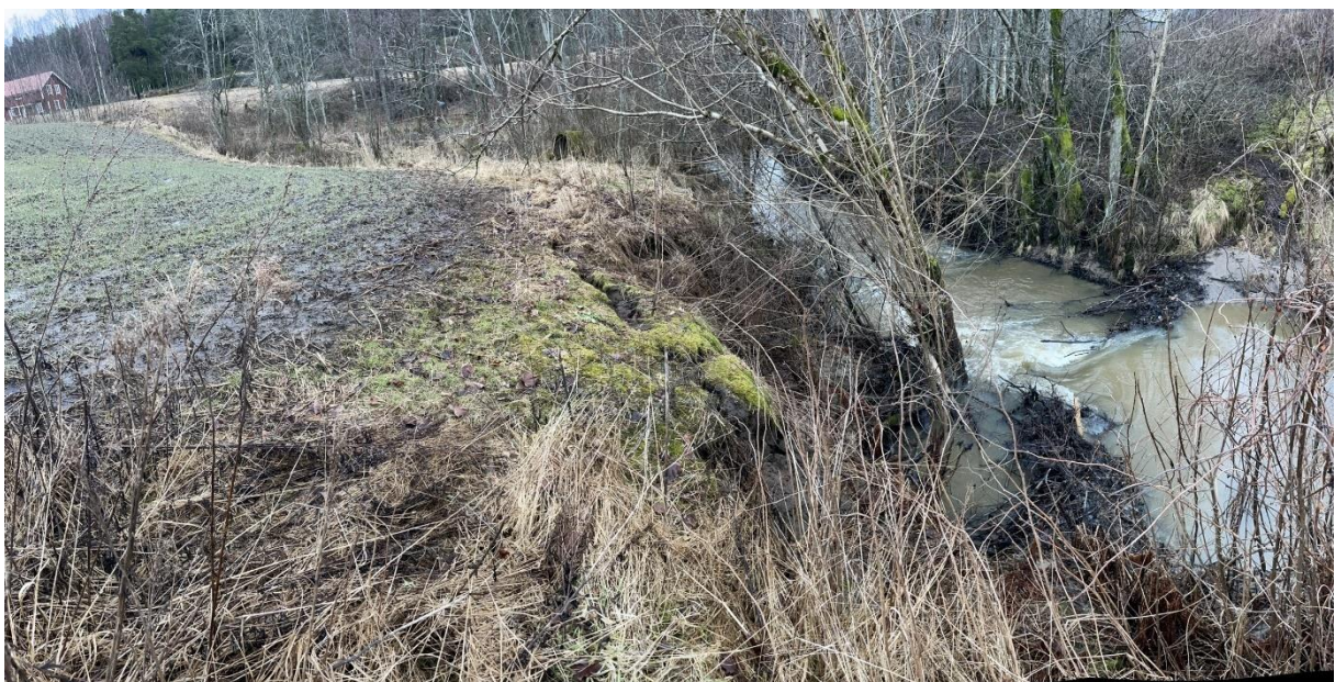
Figur 3-3 Manglende kantskog, bratte bekkekanter og jordarbeiding helt ut mot bekkekant gir utrasing og erosjon (Kirkebekken 2023, foto: Mats Finne).
